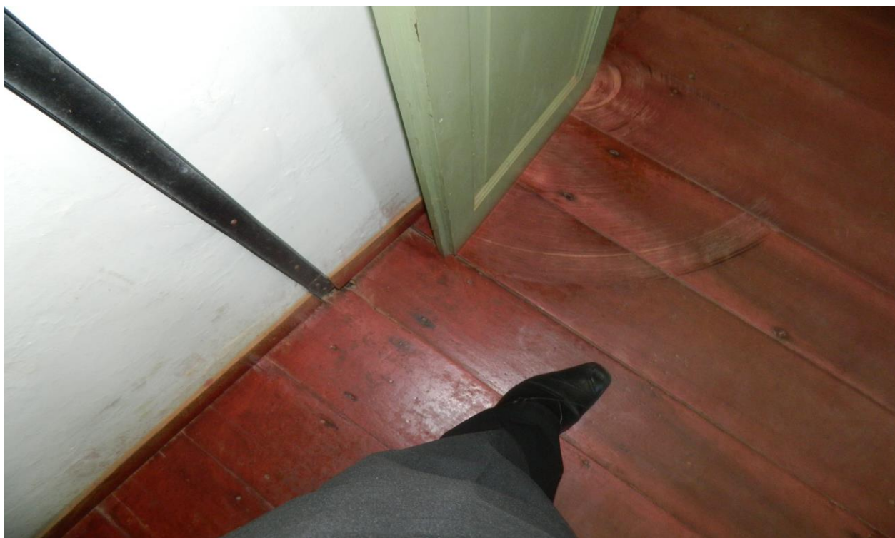
Foto 04 – assoalho de madeira afundando.
