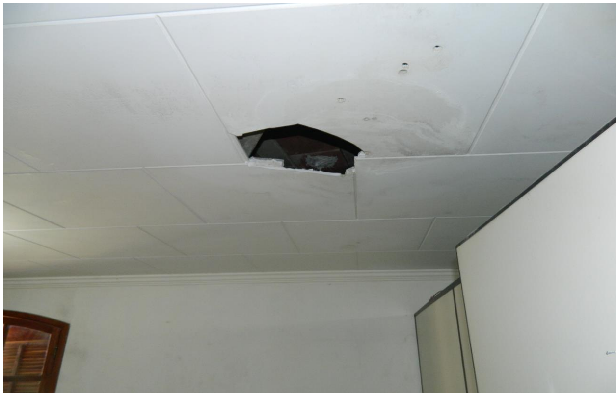
Foto 05 – desprendimento de gesso no INCAPER.
