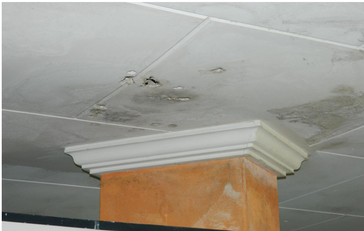
Foto 06 – infiltração no teto do INCAPER.
