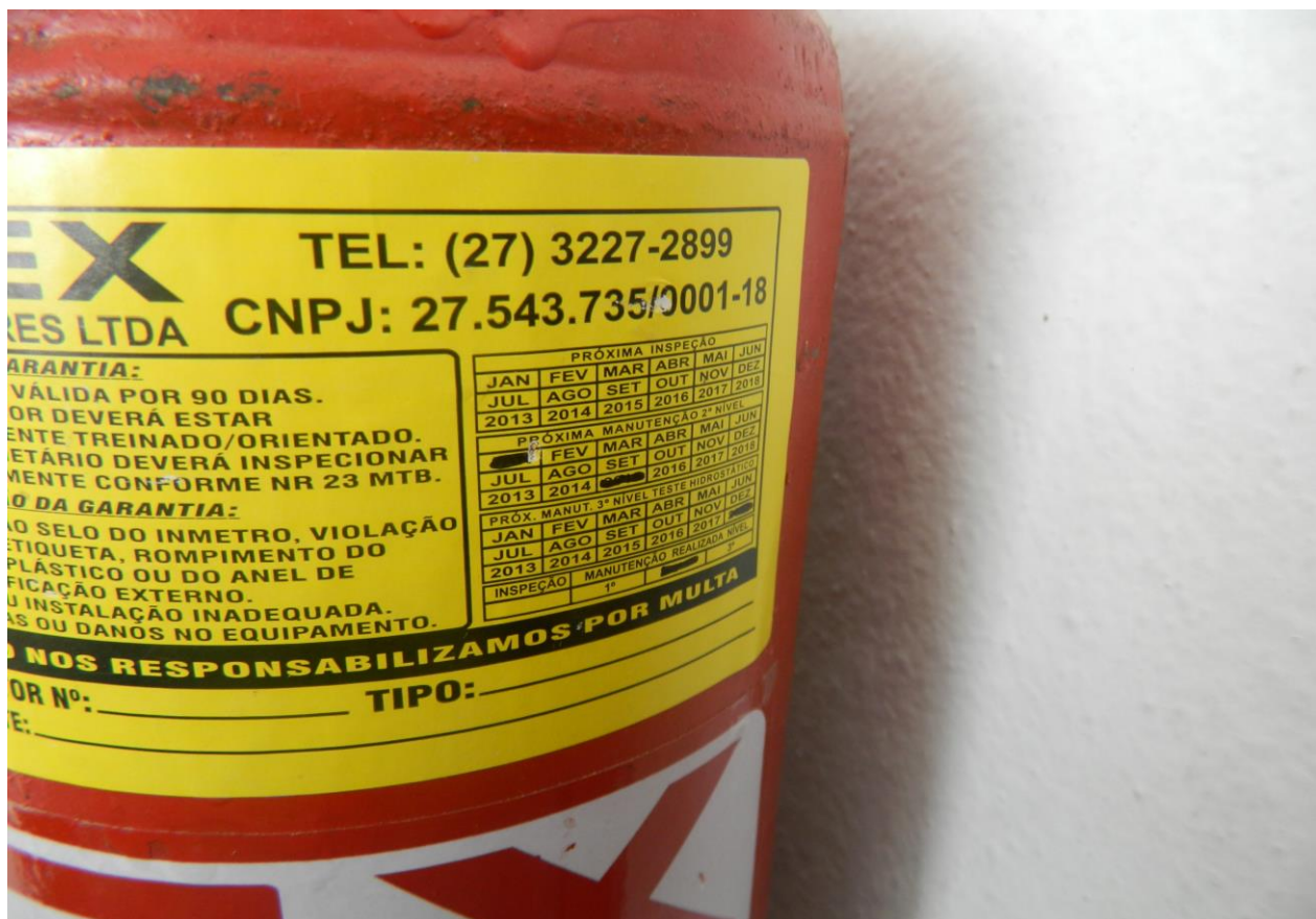
Foto 02 - extintor vencido e poucos equipamentos de combate a incêndio.
