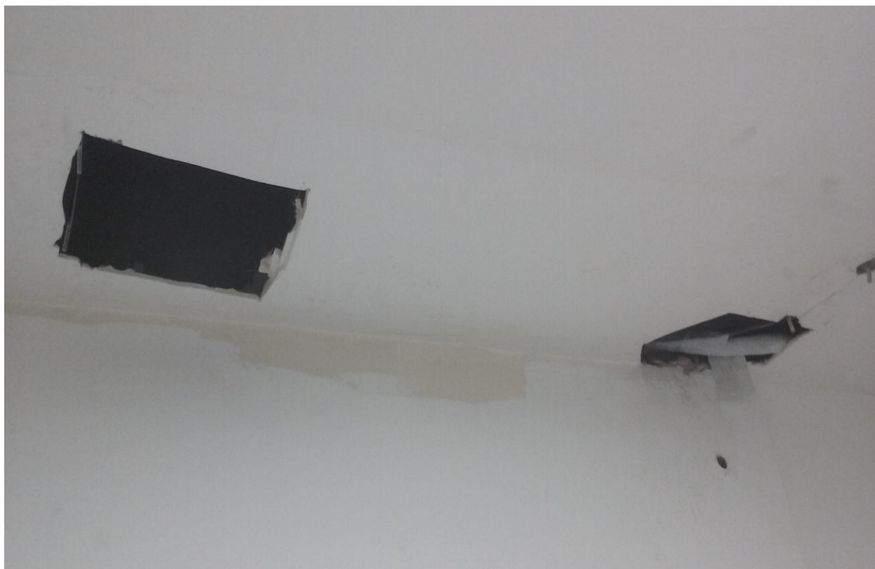
Foto 05 – vários buracos na cobertura de gesso.
