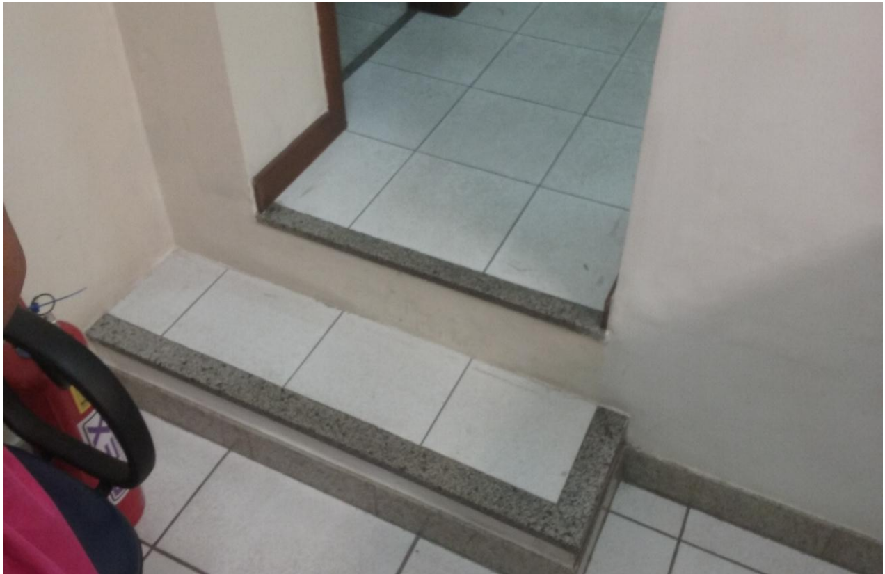
Foto 07 – banheiros sem acessibilidade.
